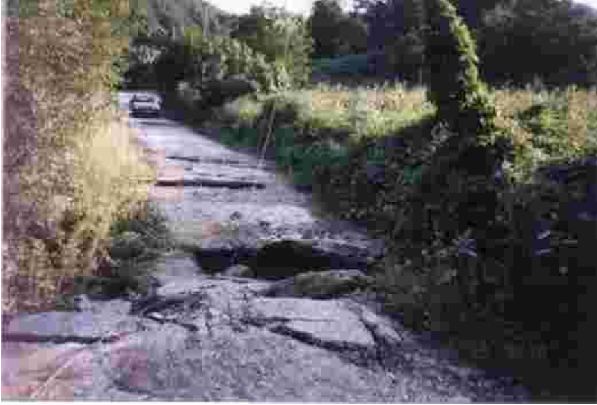
Yol Üzerinde Sağ Yanal Yer Değişirme (Yaklaşık 100 cm)
